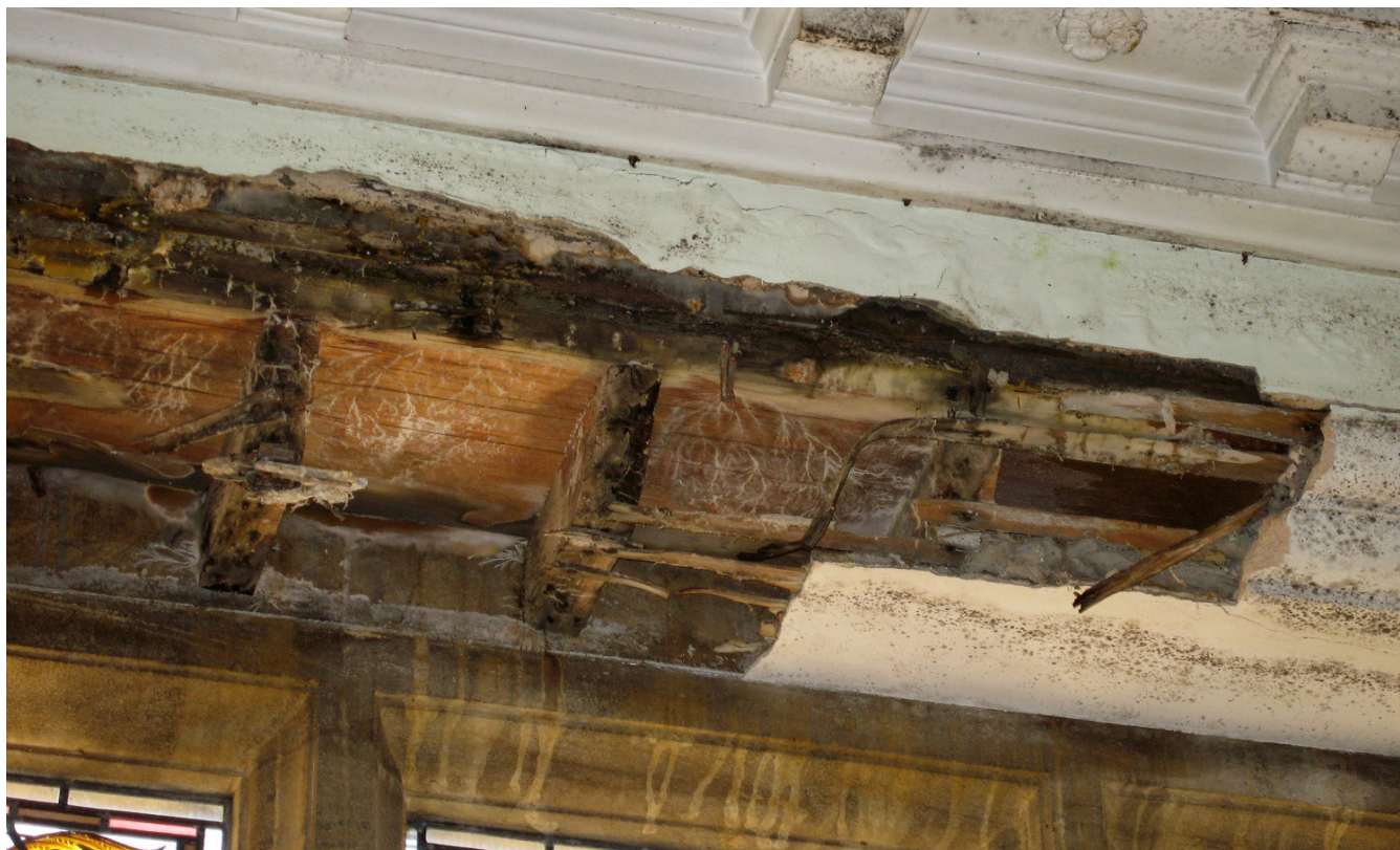
Ffigur 8: Plastr wedi cwympo ar ôl i ddŵr dreiddio trwy gafn parapet plwm (delwedd © Historic England)
