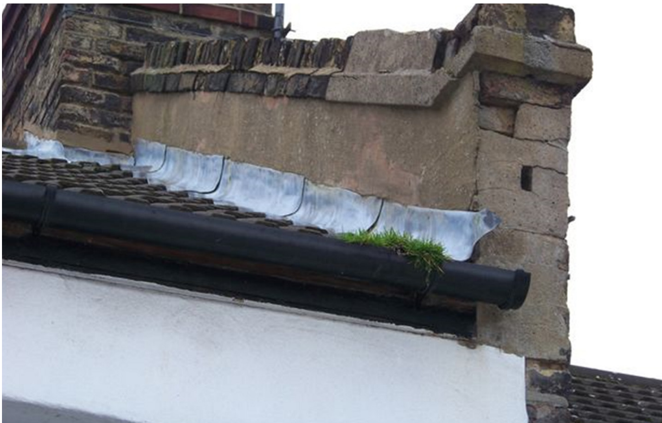
Ffigur 1: Mur parapet mewn cyflwr gwael (delwedd © PCA)
